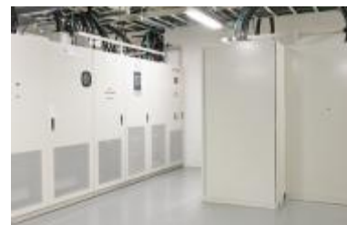
無停電電源装置(UPS)
