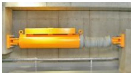
オイルダンパー(制震装置)
