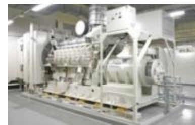
非常用発電機
