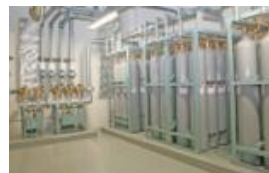
消化ボンベ室
